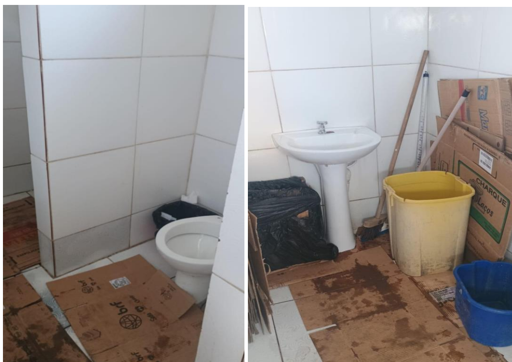
Figuras 10 e 11 - Condições sanitárias e de conforto inadequadas
