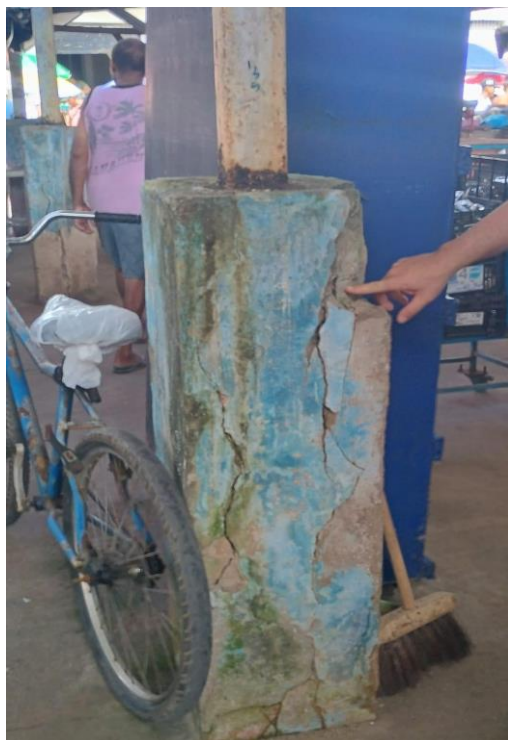
Figura 9 - Infraestrutura inadequada da feira livre de Santo Amaro
