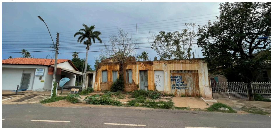
Figura 23: Ruínas rua Getúlio Vargas, Corrente, PI
