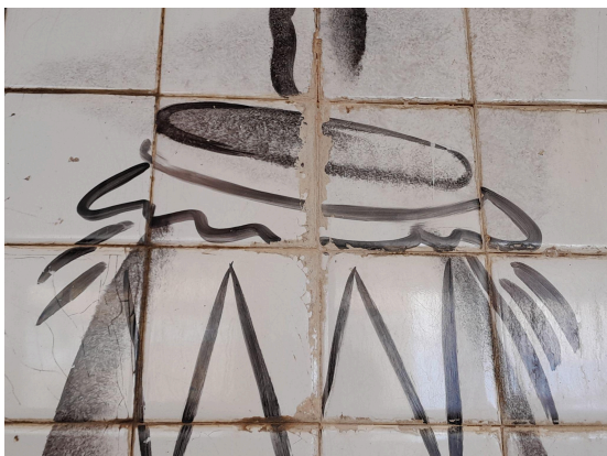
Figura 60 - Detalhe da perda do vidrado nas arestas no painel azulejar.
