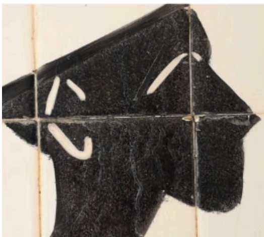
Figura 74 - Eflorescência sobre a face da imagem do painel 10. O aspecto de escorrimento pode ser observado. Fonte: Acervo pessoal, 2024.
