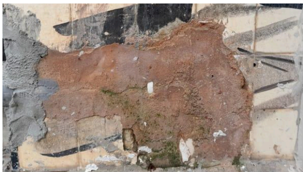
Figura 71 - Imagem da base do painel 8 com presença de limo. Fonte: Acervo próprio, 2024.
