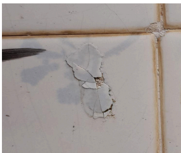
Figura 57 - Revestimento azulejar apresentando o destacamento do vidrado.
