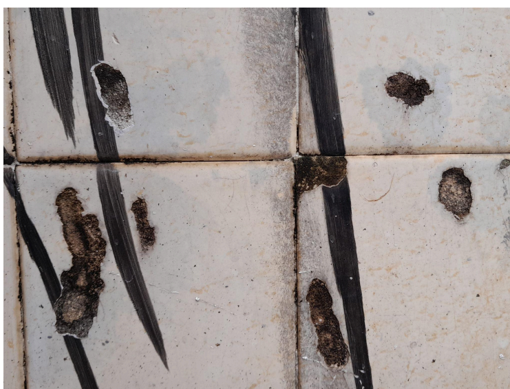
Figura 66 - Detalhe do painel 9 onde se localiza um início da desagregação da chacota.
