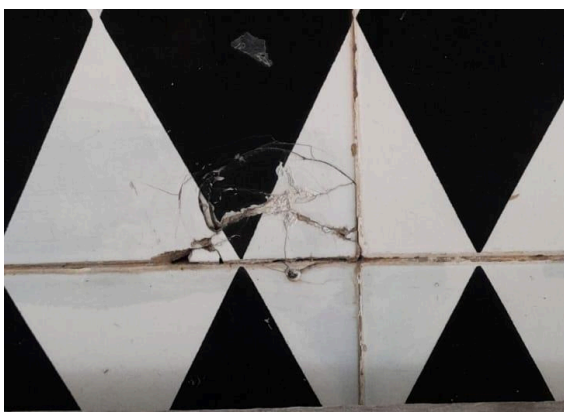
Figura 65 - Fratura observada na face do P12. Fonte: Acervo próprio, 2024.
