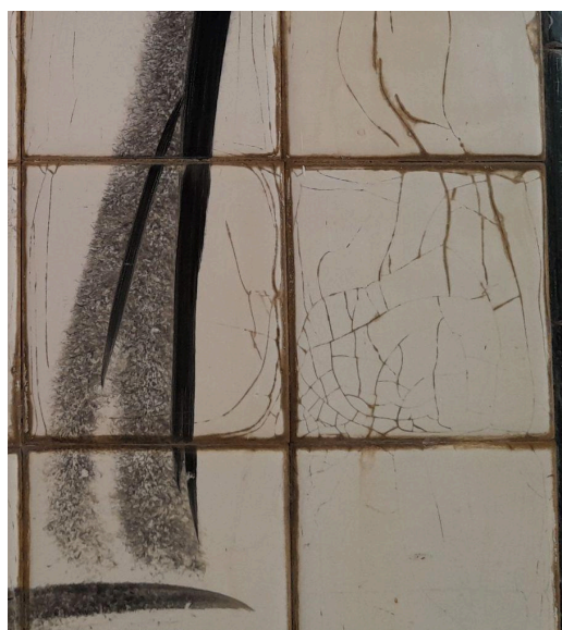
Figura 54 - Detalhes de fissuras por gretamento (craqueles) no painel azulejar, painel 4.
