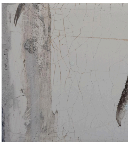
Figura 53 - Detalhes de fissuras por gretamento (craqueles) no painel azulejar, painel 1.
