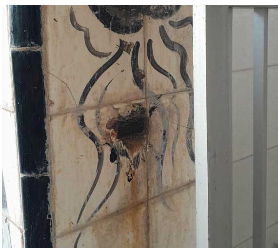
Figura 55 - Manchas com alteração cromática.
