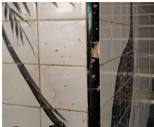
Figura 46 - Desplacamento da peça de azulejo situada na lateral do painel artístico 8, localizado no playground do Edifício Avany.
