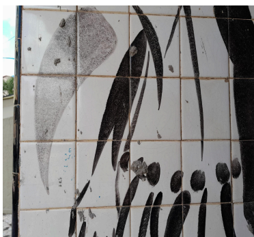
Figura 51 - Vestígios de materiais construtivos (cimento), painel 01.
