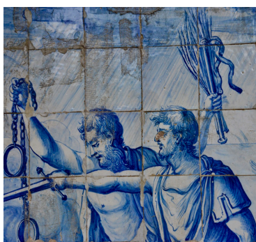
Figura 83 – Detalhe da perda do vitrado em um dos painéis do claustro.
