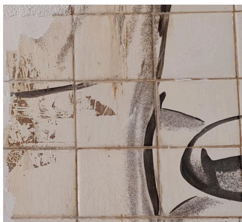
Figura 49 - Manchas de cola e resíduos no painel 4. Fonte: Acervo pessoal, 2024.
