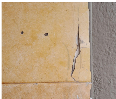
Figura 58 - Destaque do destacamento do vidrado no painel 11.
