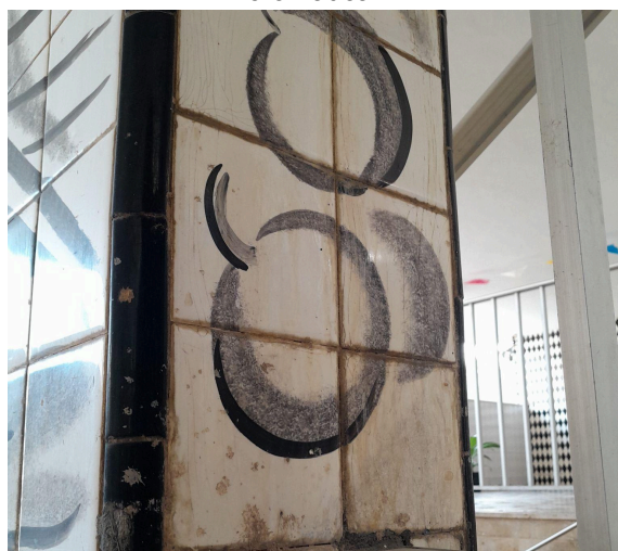
Figura 56 - Detalhe de manchas com alteração cromática.
