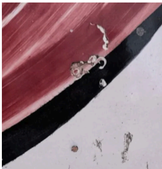
Figura 67 - Imagem do painel 12 com pontos de dano de picagem.
