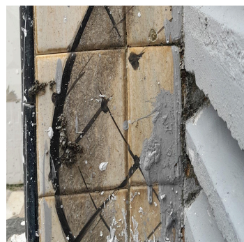
Figura 52 - Acúmulo de materiais construtivos (cimento e argamassa), painel 09.
