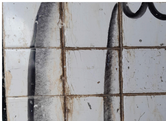
Figura 61 - Detalhe da perda do vidrado nas arestas no painel azulejar.
