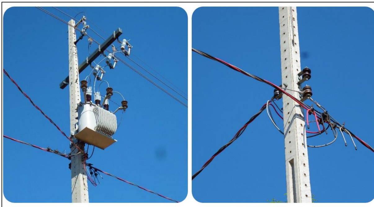
Figura 2.6 - Rede Aérea de Distribuição Isolada.
