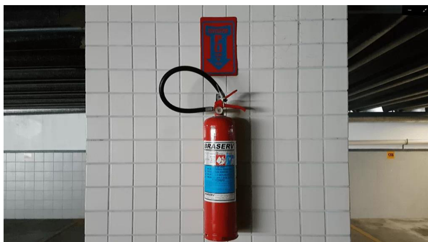
Figura 29 - Exemplo de extintor portátil
