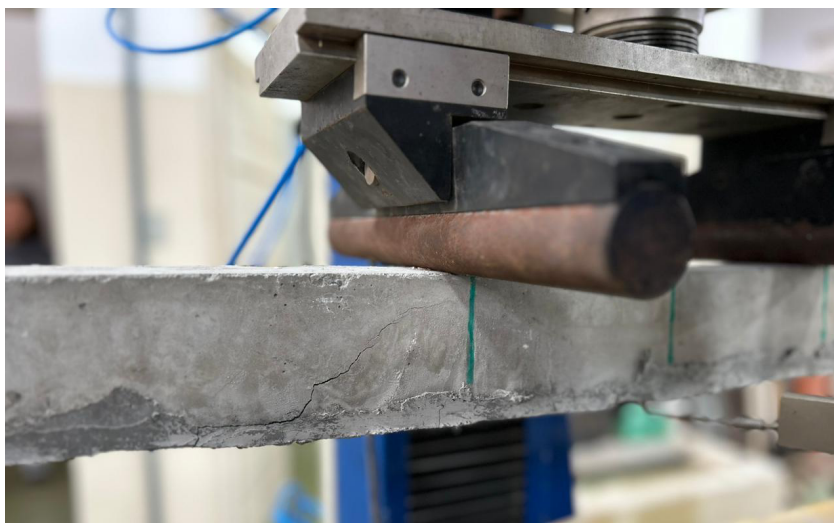
Figura 17 - Fissuração da viga reforçada com lâmina de fibra de carbono.
