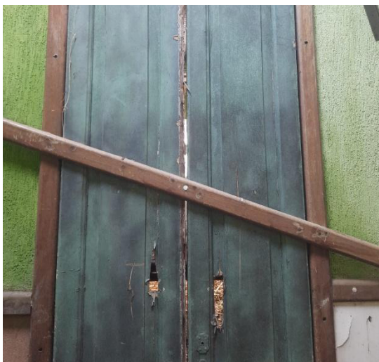
Figura 29 – Porta da sala 04 danificada
