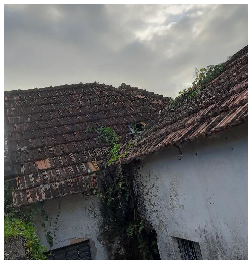
Figura 40 – Ausência de calhas
