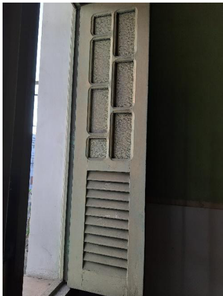
Figura 31 – Tinta desgastada da janela
