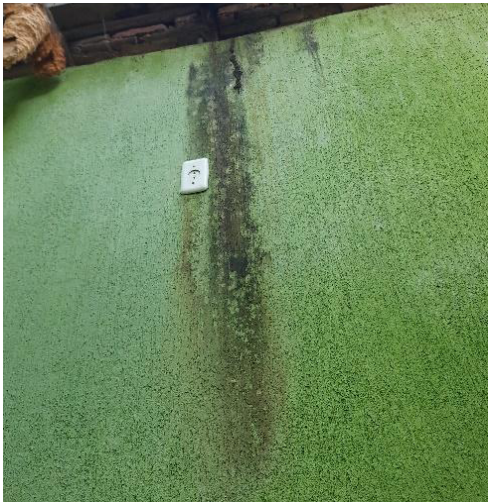
Figura 41 – Limo na alvenaria
