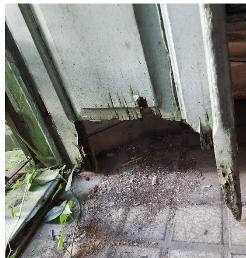
Figura 30 – Porta de acesso principal danificada
