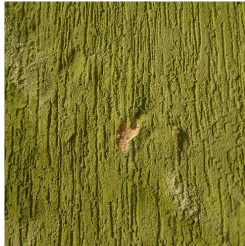
Figura 42 - Infiltração na alvenaria
