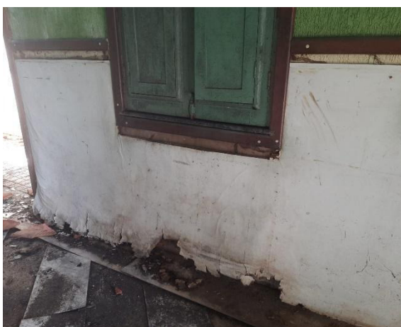
Figura 33 – Danos estruturais em meia parede de madeira na sala 01
