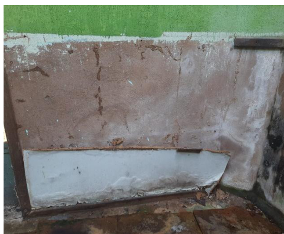
Figura 34 – Danos estruturais em meia parede de madeira na sala 04
