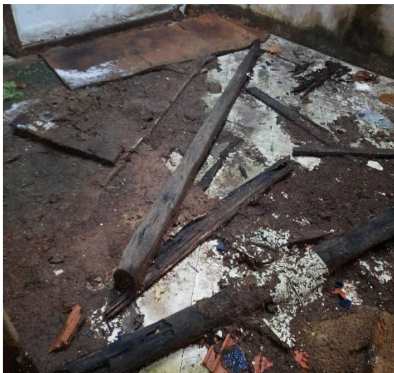
Figura 35 – Degradação de material em superfícies de madeira
