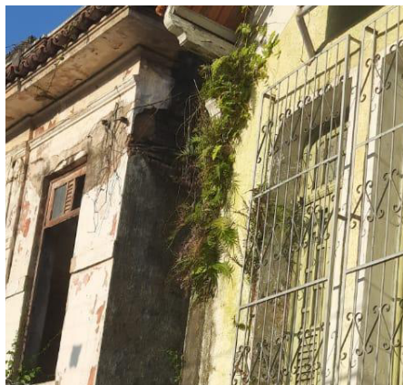
Figura 10 – Vegetação na fachada
