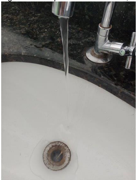
Figura 40: Entupimento em lavatório, sanitário feminino, 2º andar do Bloco D
