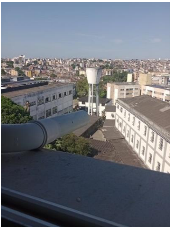
Figura 20: Tubulação com despejo livre das águas de chuva, 5º andar do Bloco A
