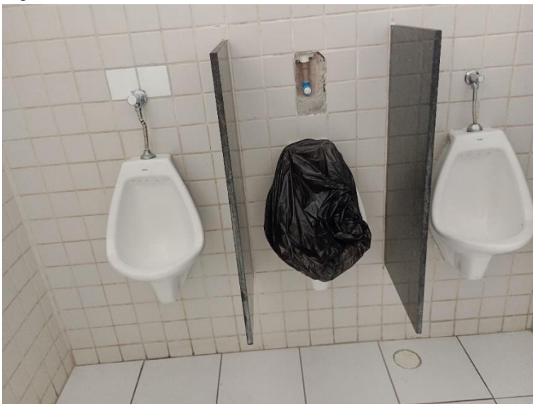
Figura 23: Mictório interditado, Bloco B, 1º andar
