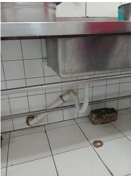
Figura 28: Sifão mal instalado e ralo seco com vedação improvisada, restaurante, Bloco B, térreo
