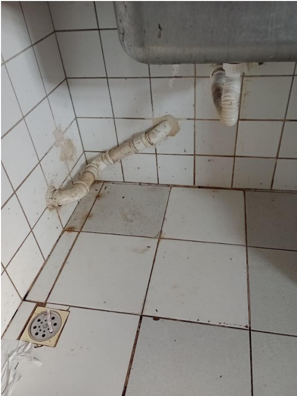
Figura 27: Sifão mal instalado, restaurante, Bloco B, térreo
