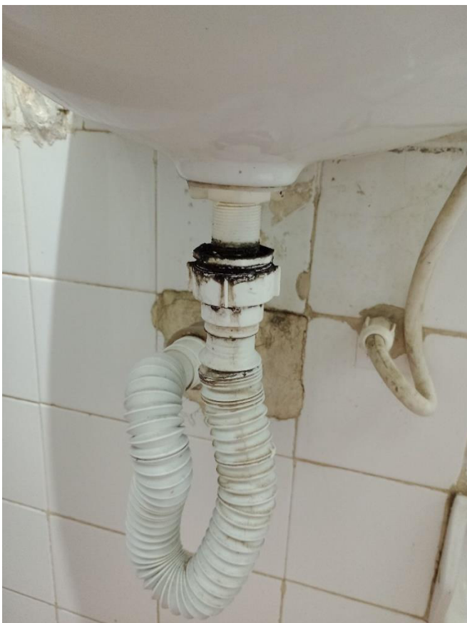
Figura 26: Sifão mal instalado, Bloco B, térreo
