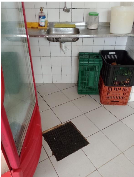
Figura 29: Caixa de gordura, cantina, Bloco B, térreo
