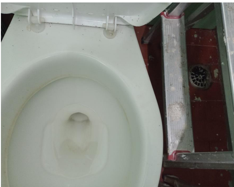
Figura 33: Salo seco entupido, sanitário dos servidores, Bloco B, subsolo
