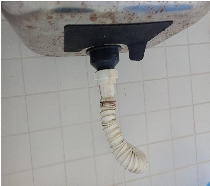
Figura 43: Ferrugem na cuba da pia da copa do departamento de construção civil, térreo do Bloco D
