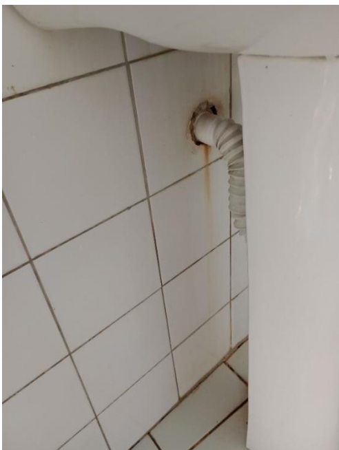
Figura 30: Vazamento no sifão do lavatório, banheiro subsolo do restaurante, Bloco B, térreo
