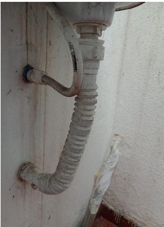
Figura 32: Sifão improvisado e com vazamento, sanitário dos servidores, Bloco B, subsolo.
