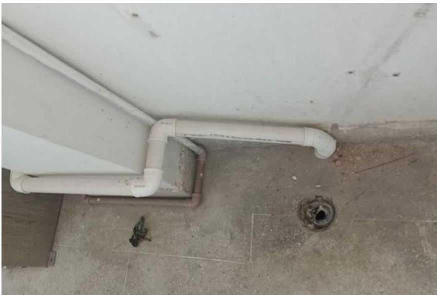
Figura 16: Ralo seco sem proteção adequada. 5° andar, Bloco A
