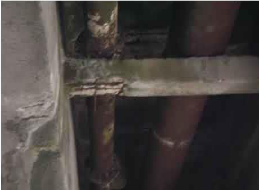
Figura 10: oxidação em tubulação de barbará
