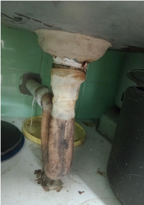
Figura 31: Sifão antigo na pia da copa, Bloco B, subsolo.
