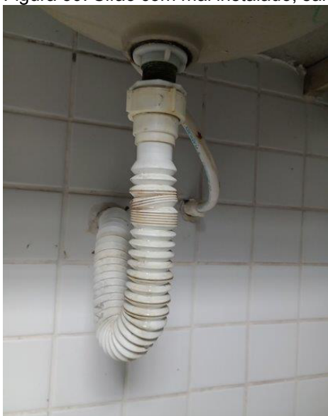
Figura 39: Sifão com mal instalado, sanitário masculino, 1º andar do Bloco D
