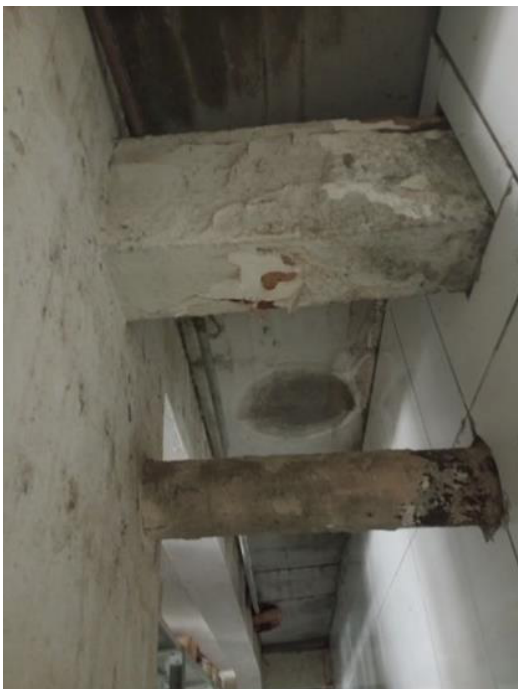
Figura 47 - Corrosão da armadura da viga devido a infiltração, almoxarifado, subsolo do Bloco D
