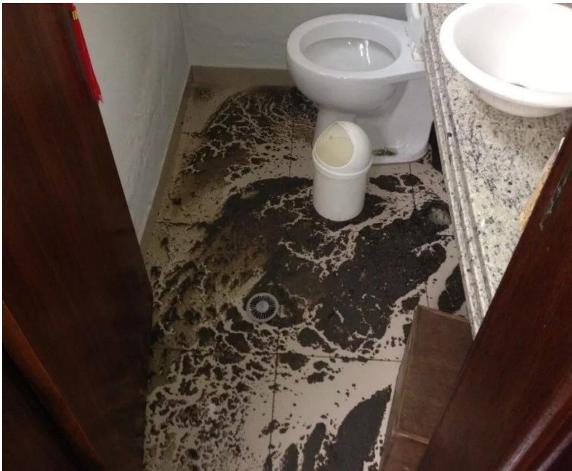
Figura 6: retorno do esgoto sanitário devido a entupimento
