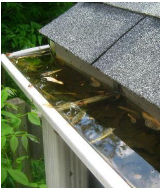
Figura 11: Entupimento em calha por acúmulo de matéria orgânica
