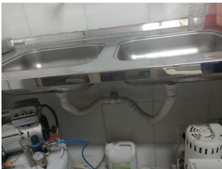
Figura 41: Sifão improvisado, SMO Bloco D
