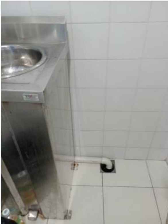
Figura 46 - Lavatório improvisado, almoxarifado, subsolo do Bloco D
