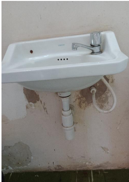
Figura 44: Lavatório da sala de topografia, térreo do Bloco D
