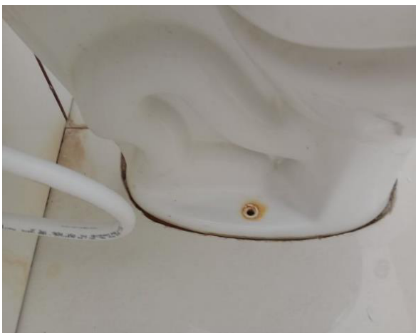
Figura 45 - Vaso sanitário mal fixado, laboratório de ensaios tecnológicos, térreo do Bloco D
