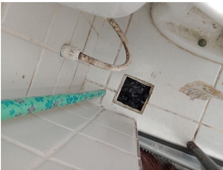
Figura 24: Vedação improvisada nas caixas sifonadas, Bloco B, 1º andar
