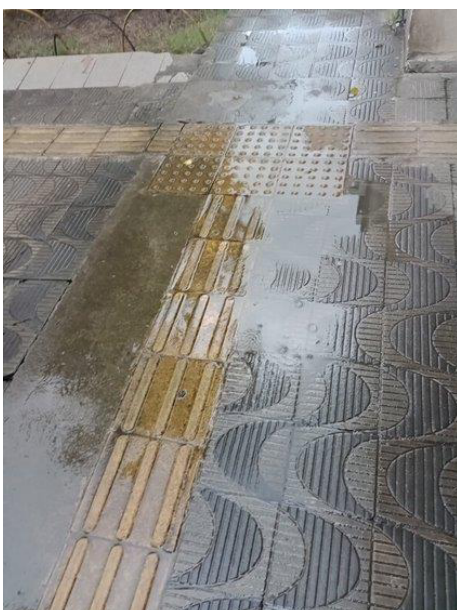
Figura 19: Acúmulo de água devido à drenagem incorreta do ar condicionado, Bloco A – área externa
