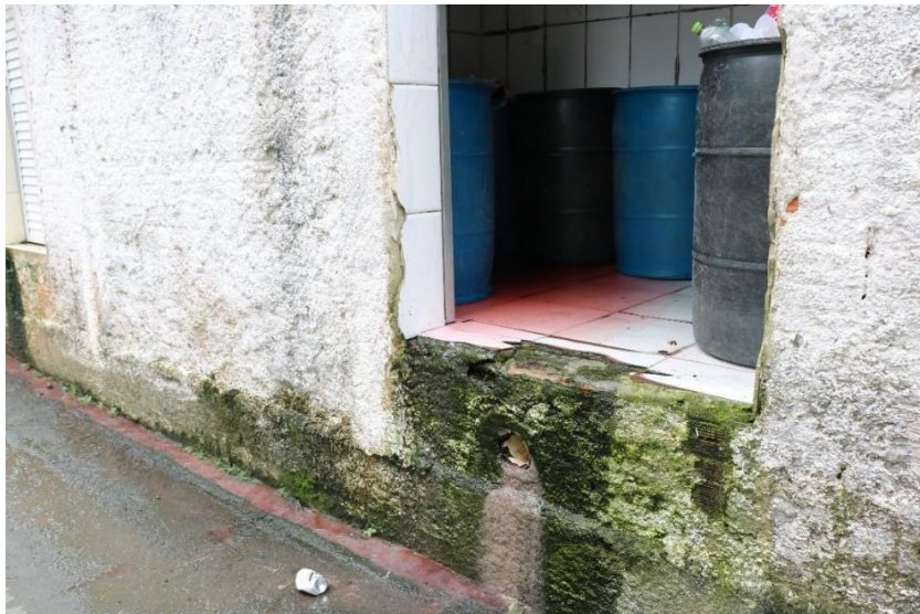
Figura 7: proliferação de limo devido à destinação final incorreta de uma tubulação
