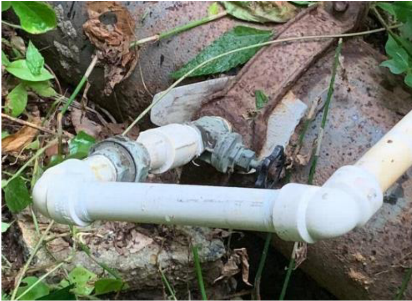
Figura 12: Ligações incorretas de esgoto e águas pluviais. Região de Joá, Rio de Janeiro
