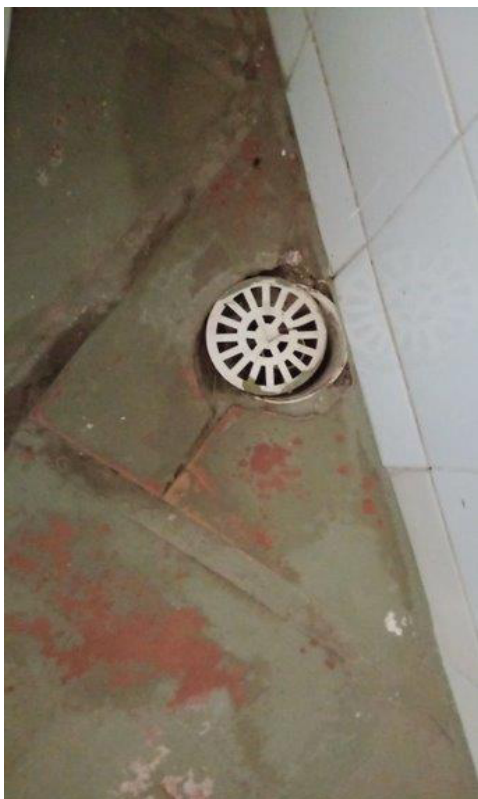
Figura 35: Ralo seco sem a devida vedação, Bloco C, térreo
