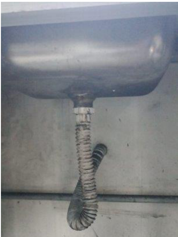
Figura 36: Sifão sem manutenção, Bloco C, térreo
