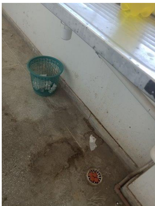
Figura 17: Ralo seco com restos de alimento embaixo da pia. 5° andar, Bloco A
