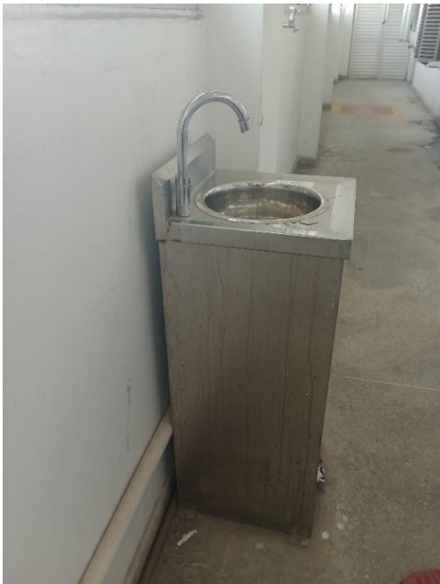
Figura 15: Pia improvisada copa, 5° andar do Bloco A
