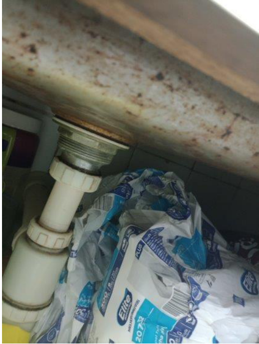
Figura 42: Sifão instalado de forma incorreta, SMO Bloco D
