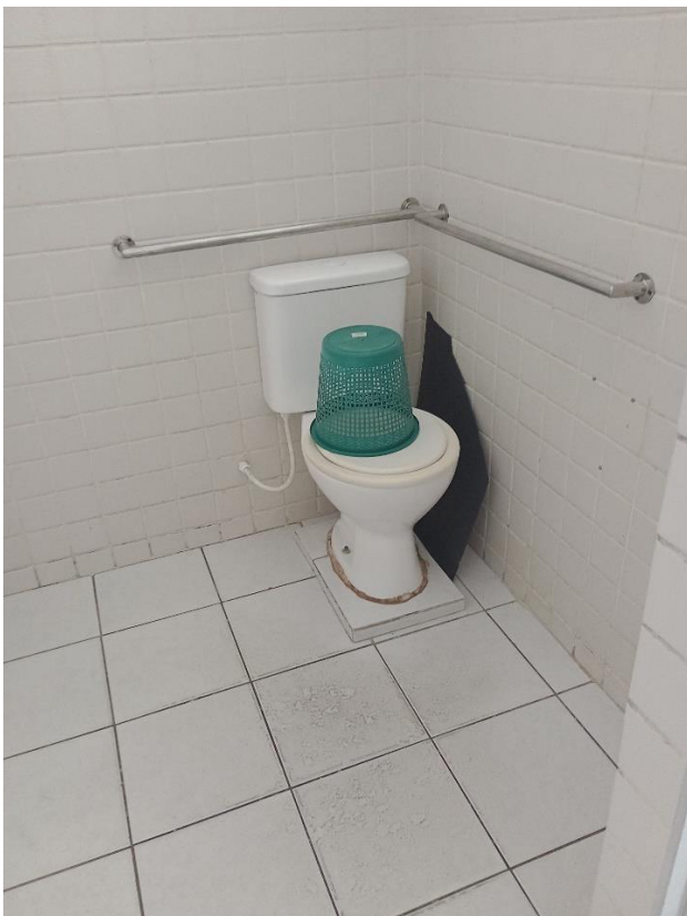
Figura 22: Vaso sanitário interditado, Bloco B, 1º andar
