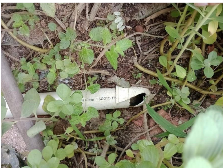
Figura 37: Tubulação exposta e rachada, Bloco C, área externa
