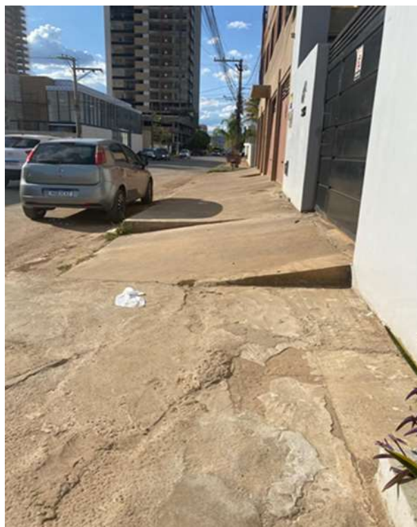
Figura 13: Desnível no passeio na rua Prof. Orlando Gomes
