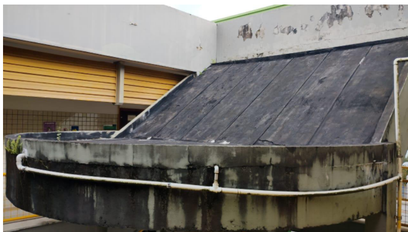
Figura 04: Área de captação, cobertura localizada na escada, parte superior da biblioteca do campus
