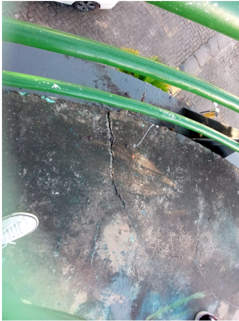
a) Fissura e fungos na região do pilar cogumelo.
