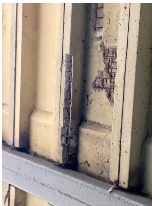
b) Corrosão na armadura exposta
