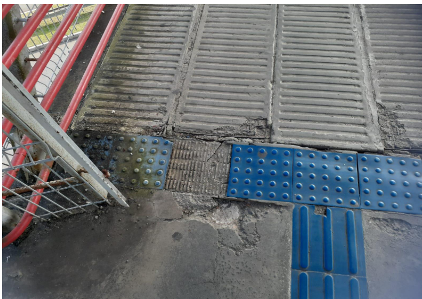
Figura 8 - Degradação das placas de piso das passarelas
