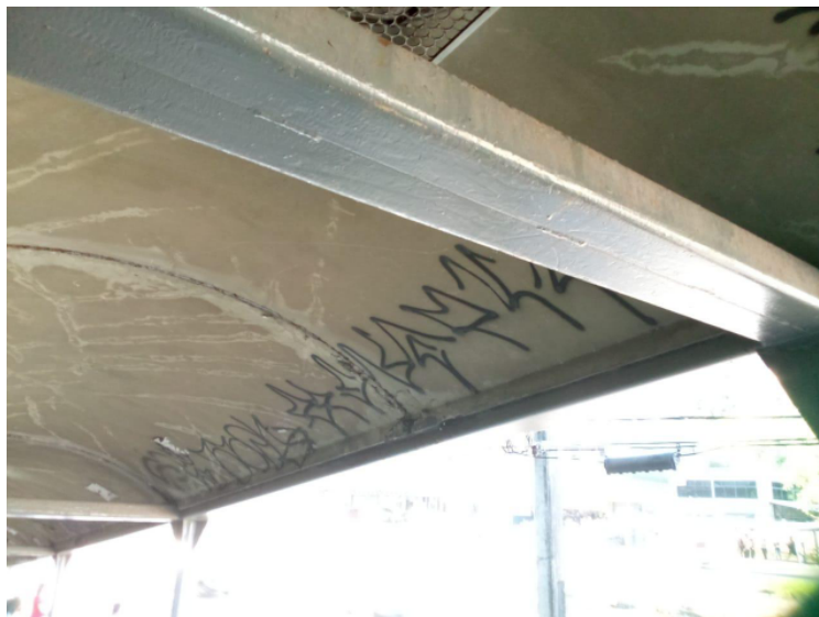
Figura 9 – Eflorescência nas passarelas
