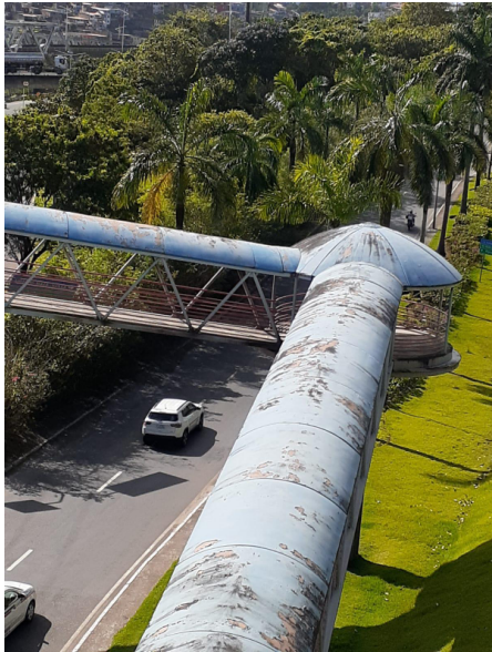
a) fungo na cobertura da passarela
