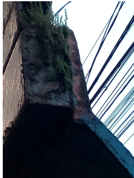
b) vegetação na viga metálica
