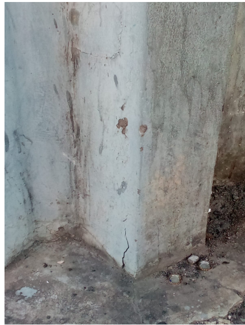
b) Fissura de corrosão no “pé” do pilar.
