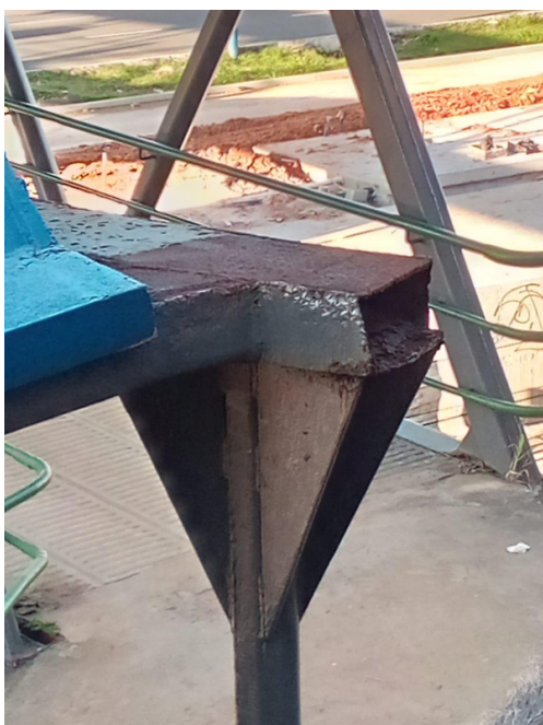
a) Corrosão da viga metálica
