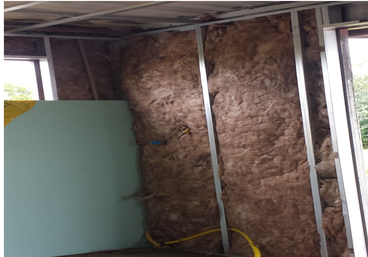
Figura 14: Sistema de Isolamento Termoacústico - Lã de vidro.
