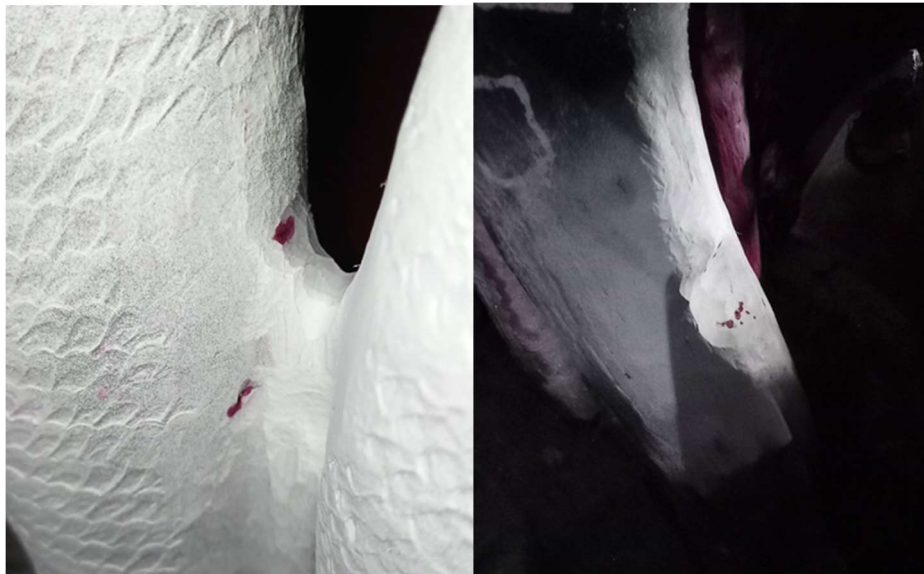
Figura 2.11 – Detalhe de tubos com weld overlay após ensaio de líquido penetrante, apresentando descontinuidade localizada (trincas), na região da fornalha. Fonte: própria.
