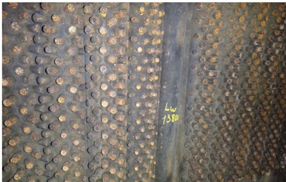
Figura 2.6 - Tubos pinados da fornalha de uma caldeira de recuperação química. Fonte: ISQ BRASIL, 2014, Apud PENA, 2016.
