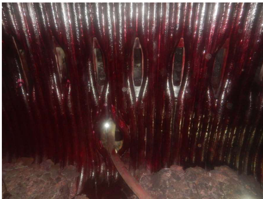
Figura 2.9 – Detalhe de tubos com proteção do tipo weld overlay na região da fornalha baixa evidenciando as aberturas de ar primário (superior) e abertura de bica de smelt (inferior). Fonte: própria.
