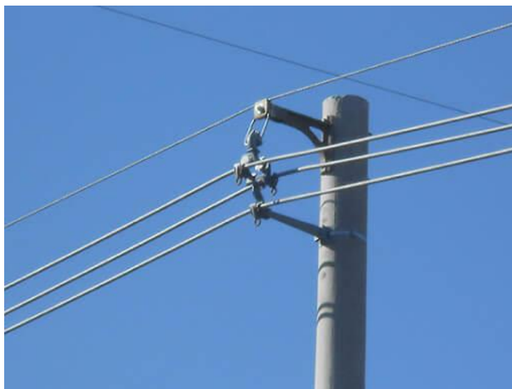
Figura 5. Rede aérea compacta.
