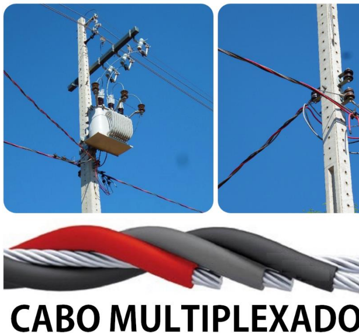
Figura 4. Rede aérea isolada com cabo multiplexado.
