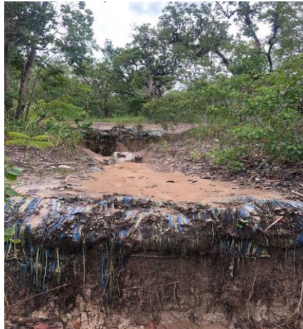
Figura 14: Fotos de Erosão na Cachoeira do Redondo.
